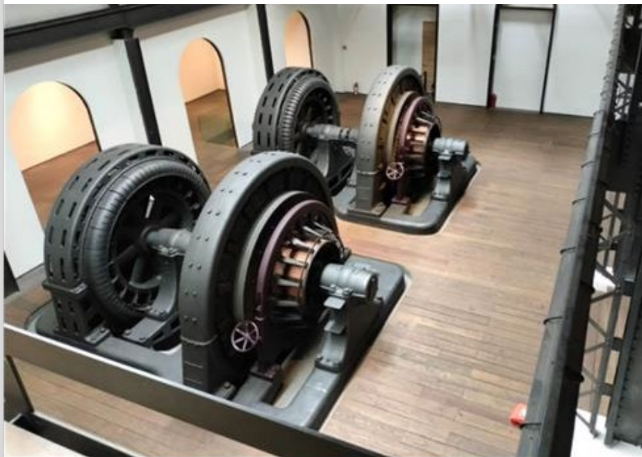
Imagen 21. Zona de turbinas.
