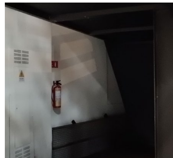
Imagen 144. Extintor en PB, bajo las escaleras
