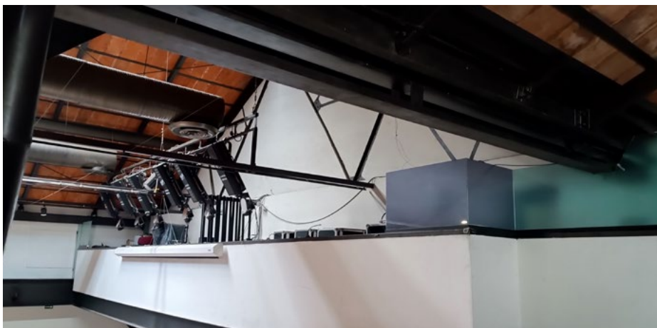
Imagen 117. Zona de cabina
